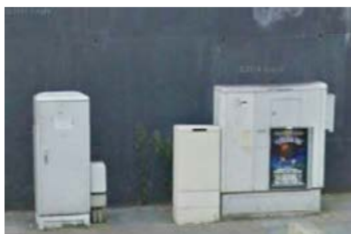
Er zijn maar weinig elektriciteitskasten aanwezig
